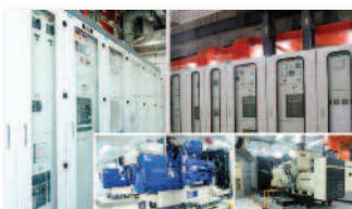
Hệ thống điện động lực / Electrical system
